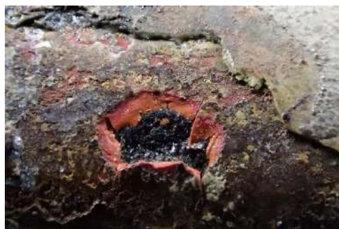
図 5-3 鏝縁の塗膜欠損部
